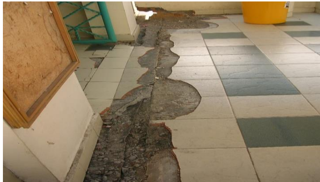
Gambar 1. 6 Penghubung antar bangunan yang rusak saat gempa 2006
