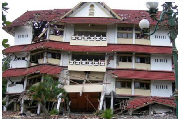
Gambar 1. 5 Bangunan STIE KERJASAMA hancur akibat gempa 27 Mei 2006 di Yogyakarta (Sumber : Raharjo dkk, 2007)
