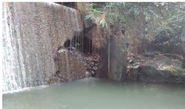
Gambar 1.1 Kerusakan pada tubuh DAS
