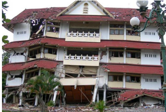
Gambar 1.3 Bangunan STIE KERJASAMA hancur akibat gempa 27 Mei 2006 di Yogyakarta (Sumber : Raharjo dkk, 2007)
