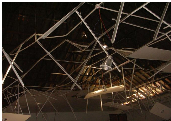
Gambar 1.4 Kerusakan Plafon di bangunan pembelajaran UMY pada gempa 27 Mei 2006
