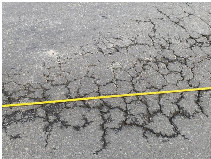
Gambar 1. 1 Retak kulit buaya ( alligator cracking )
